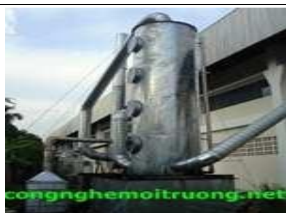
Xử Lý hơi acid Công ty Cổ phần Tôn Đông Á – Bình Dương
