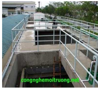
200 m 3 /ngày đêm Nhà máy giặt tẩy Domex Quận Thủ Đức
