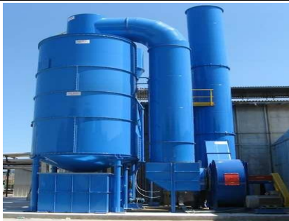
Lọc khói đốt lò hơi đốt củi Công ty May mặc Nguyên Dững Quận 12
