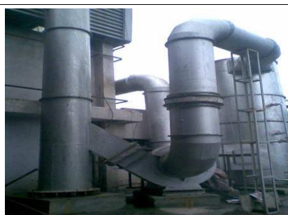
Lọc khói đốt lò hơi đốt củi Công ty Đức Phú Minh Quận 12 – TP.HCM
